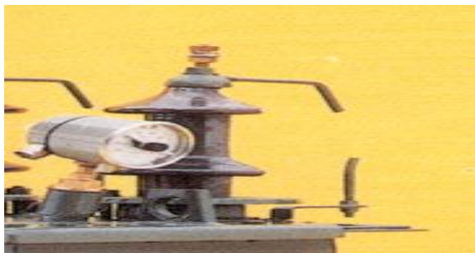
شکل ۵: برقگیر شاخکی نصب شده روی یک ترانسفورماتور توزیع
