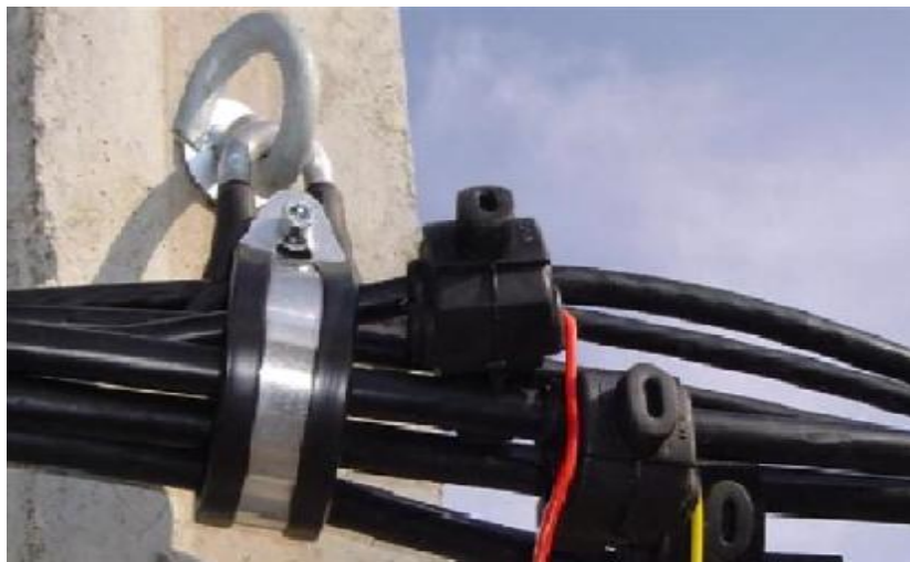
شکل ۲۴: نمای یک کلمپ فشار ضعیف در شبکه اجرا شده
