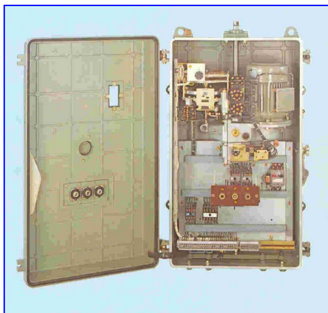
شکل ۱-۲۲: تابلوی کنترل تپ چنجر On Load ترانسفورماتور قدرت فشارقوی
