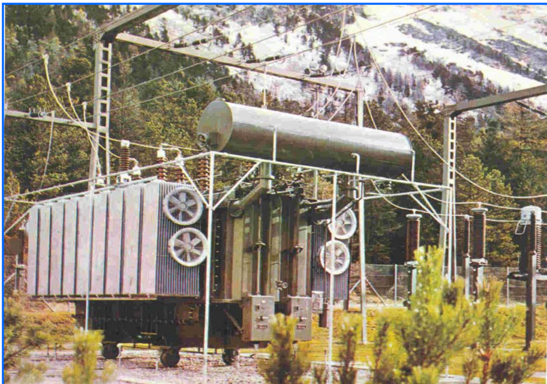
شکل ۵-۱ ترانسفورماتور قدرت فشارقوی با توان ۸۰ MVA و ولتاژ ۶۳/۱۱ KV
