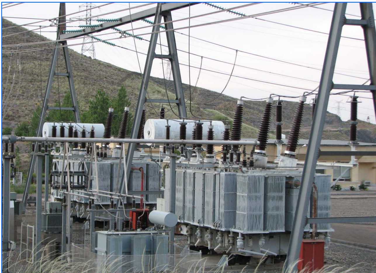
شکل ۱۳- اتوترانسفورماتور با قدرت نامی ۲۴۰ MVA و ولتاژ ۲۳۰ / ۱۳۲ / ۲۰ KV
