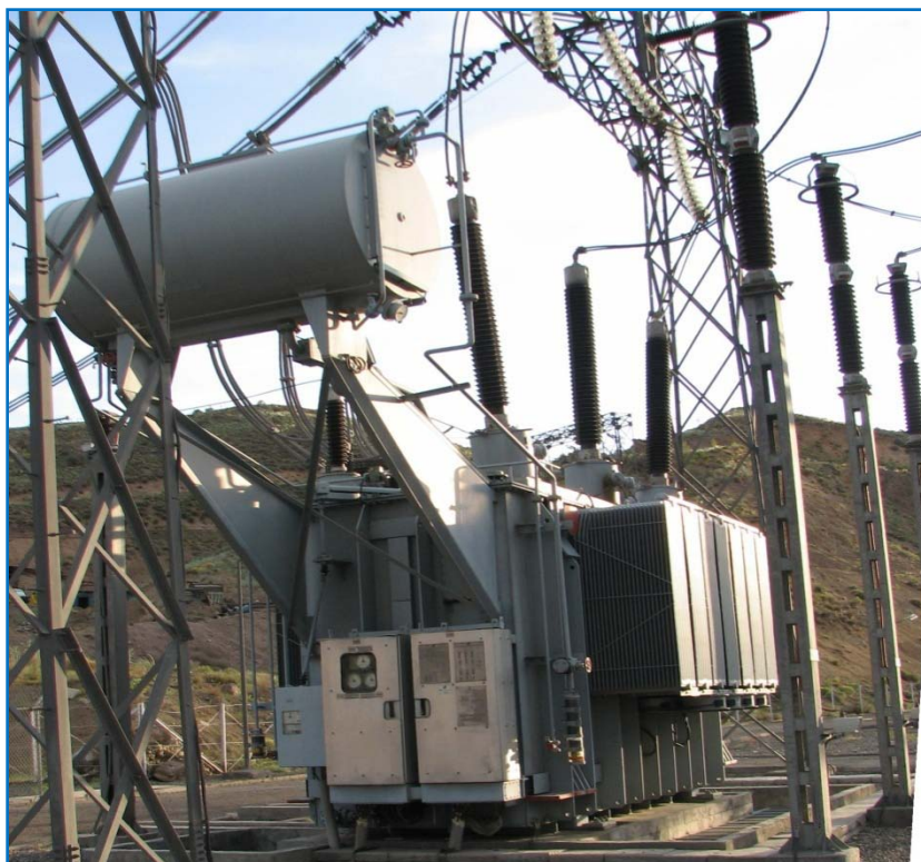
شکل ۱۴- ترانسفورماتور با قدرت نامی ۱۲۵ MVA و ولتاژ ۲۳۰ / ۲۰ KV
